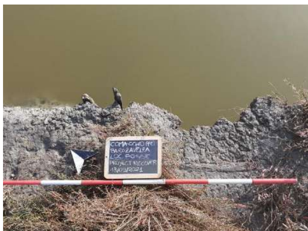
Figura II.I.8 – 6 - Comacchio, settore a Sud del Canale Fosse, Valle Fossa di Porto: dettaglio di pali infissi e
