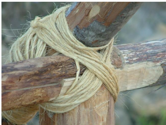
Fig. 1. particolare costruttivo relativo al fissaggio con fibre vegetali di travi portanti della capanna.
