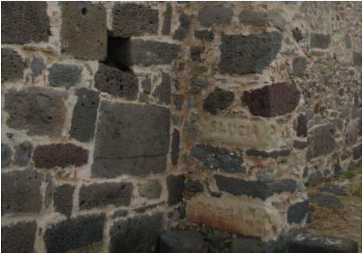
Foto 1.1.5: particolare contrafforte parete Nord-Est
