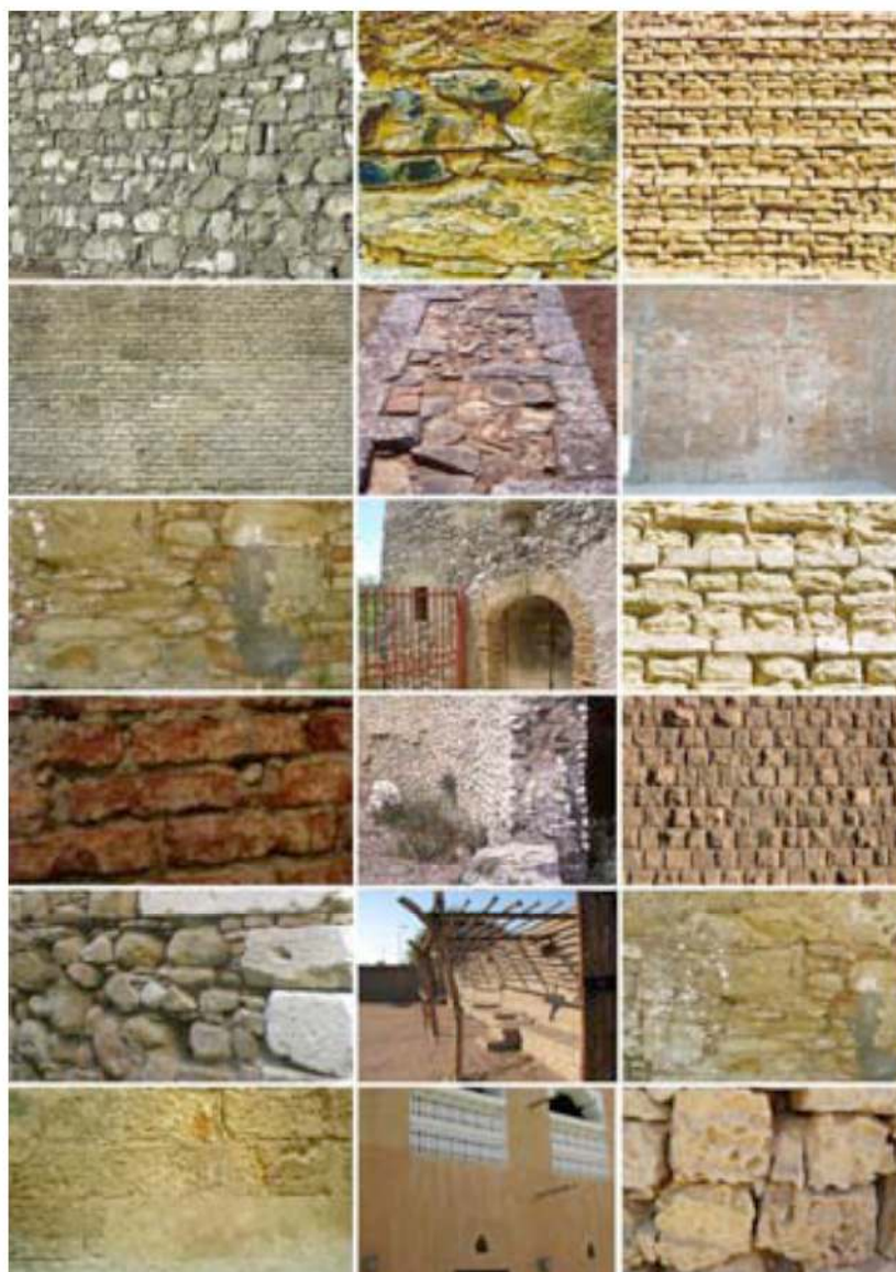
Figura 7.31. Varie tipologie murarie presenti nell'edilizia storica. La conformazione di queste strutture edilizie è molto disomogenea, caratterizzata da un'alternanza di materiale, tessiture diverse sovrapposte e molteplici ponti termici (causati da mancanza di legante o deterioramento).
